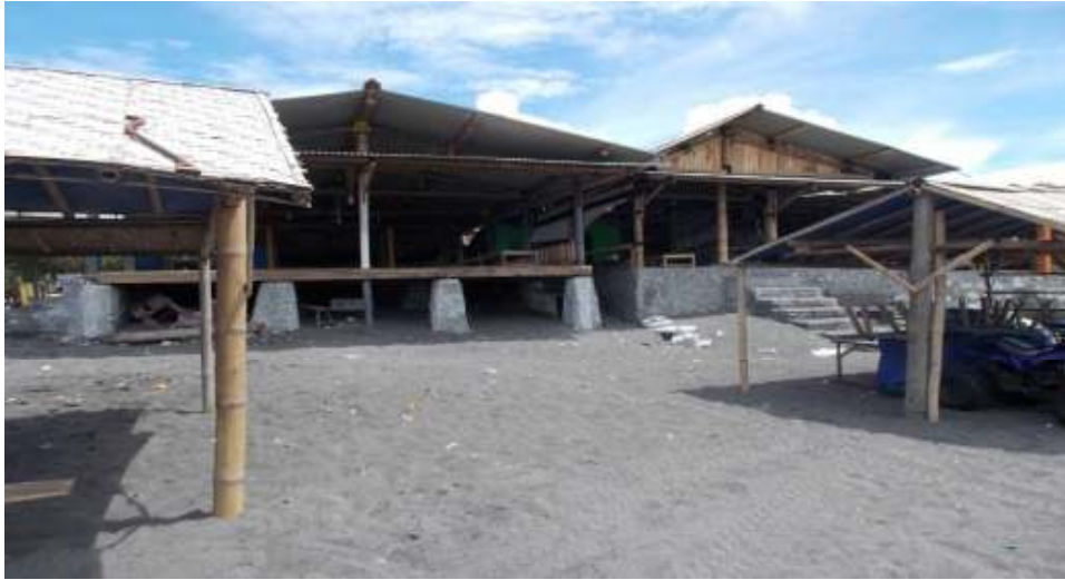
Gambar. 3 Bangunan baru setelah erosi di Pantai Depok (Foto : Arbain R, 2013).
