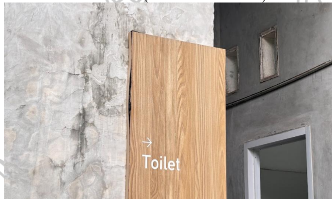
Gambar 4. 20 Finishing Papan Penanda Toilet yang Mulai Mengelupas pada Cabang BTP Sumber : (Dokumentasi Pribadi)
