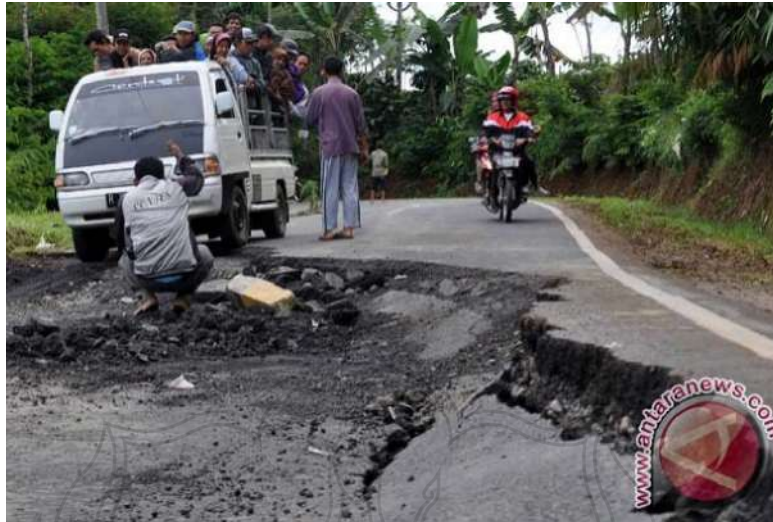
Gambar 3: Mobil bak terbuka mengangkut penumpang melewati jalan rusak fotografer: Anis Efizudin
