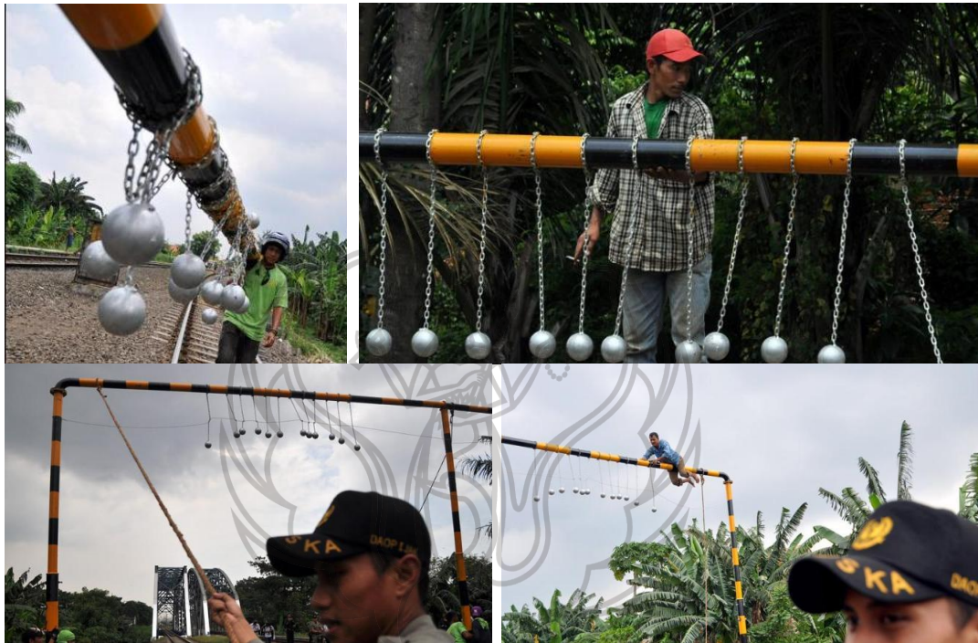
Gambar 4. Pemasangan instalasi bola beton untuk menghalau penumpang di atap gerbong (Sumber: Dokumentasi foto-foto oleh Indonesian Railfans – Jakarta; Tanggal pengambilan foto 17 Januari 2012, di Bekasi)
