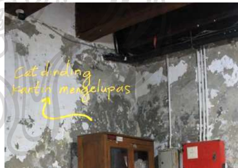
Gambar 2.20 Potret cat dinding mengelupas (Sumber: Dokumentasi pribadi 2025)
