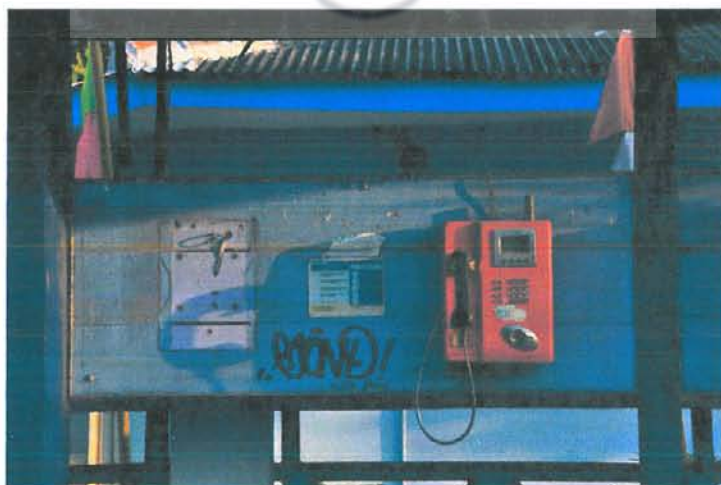
Gambar. 2 : vandalism telpon umum, Dok. Ferry Arwis
