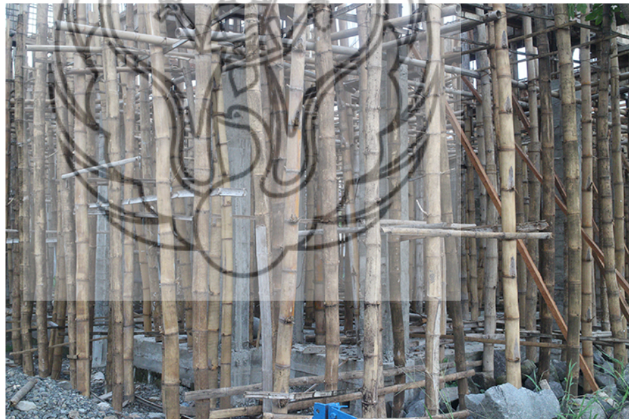
Gbr. 1. Pengecoran tiang pada bangunan dengan menggunakan bambu sebagai perancah (Foto: Andri Hervian, 2014)
