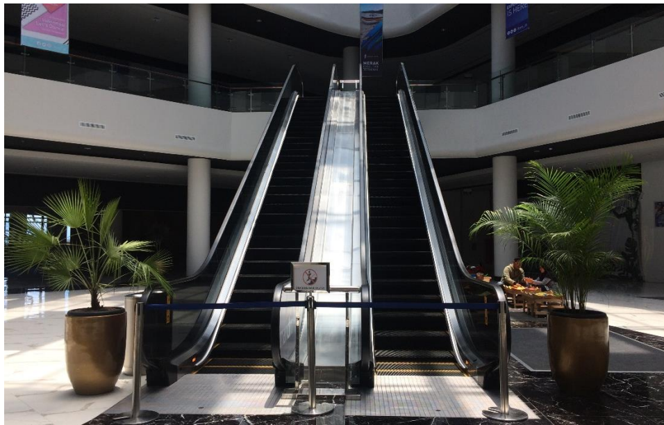
Eskalator ke Lantai 2 (Sumber : Rutmauli Panjaitan, 2019)
